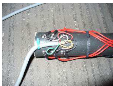
頭部結線状況
