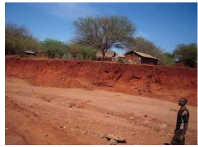
写真③水衝部の浸食が顕著
