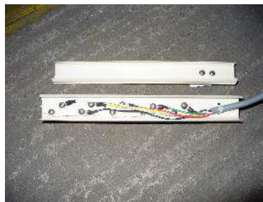
センサー配線状況
