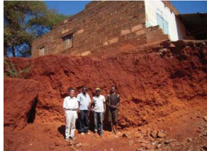
写真②右岸の浸食は建物基礎まで達した
