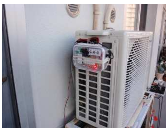
写真-7 空調機の室外機に固定したモニター
