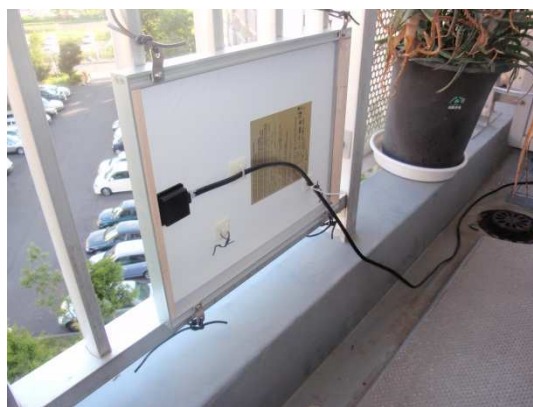
写真-6 ソーラーパネル配線状況
