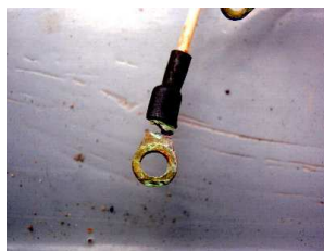
写真-8 電蝕した圧着端子
