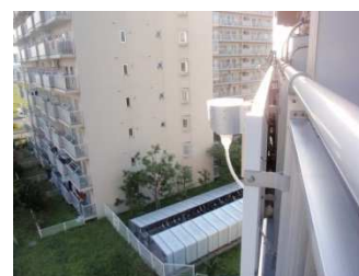
ベランダから張出した受水部
