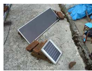
屋上のソーラーパネル
