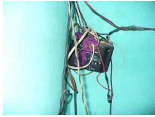
埃まみれの電池とコントローラー
