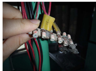
破断したケーブル接続部
